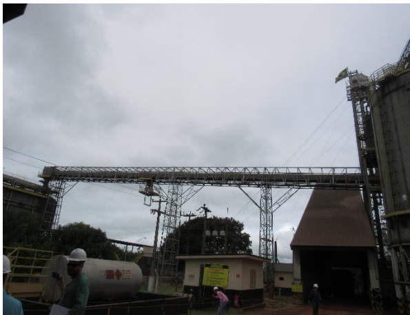
Correia transportadora, passarela e torres
