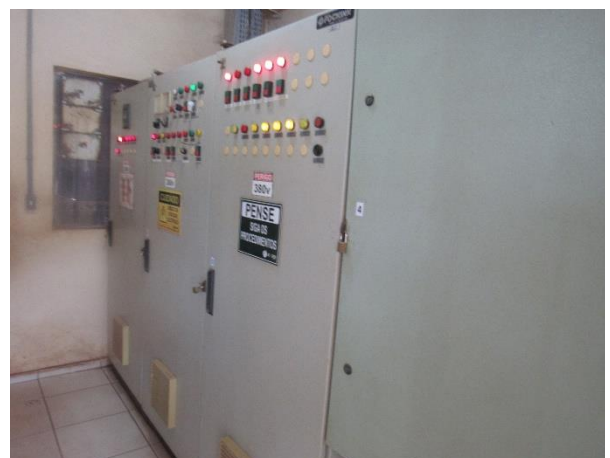
Painel elétrico tipo CCM
