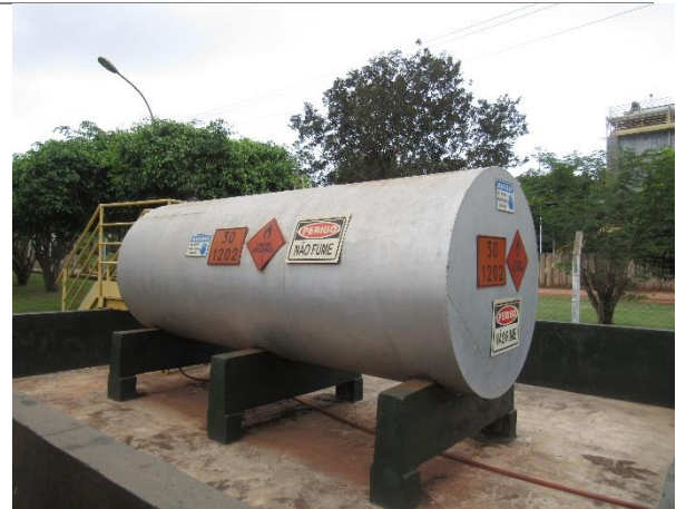
Tanque de óleo diesel do gerador
