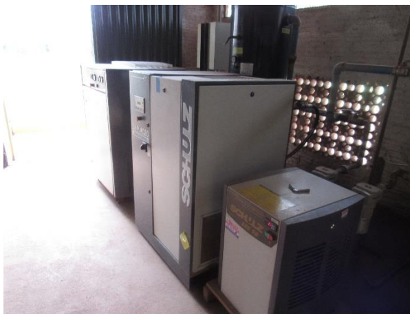
Compressores, secador e tanque de ar comprimido
