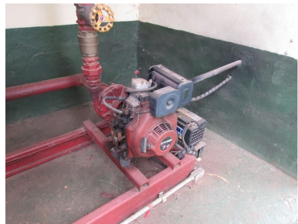
Bomba de combate a incêndio
