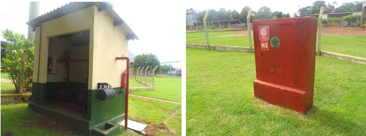
Figuras 7 e 8 - Casa de Bombas e Hidrante.
