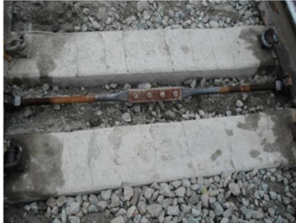
Figura 13 — Dormentes fissurados no meio do vão (Fonte: NTSB, 2014)
