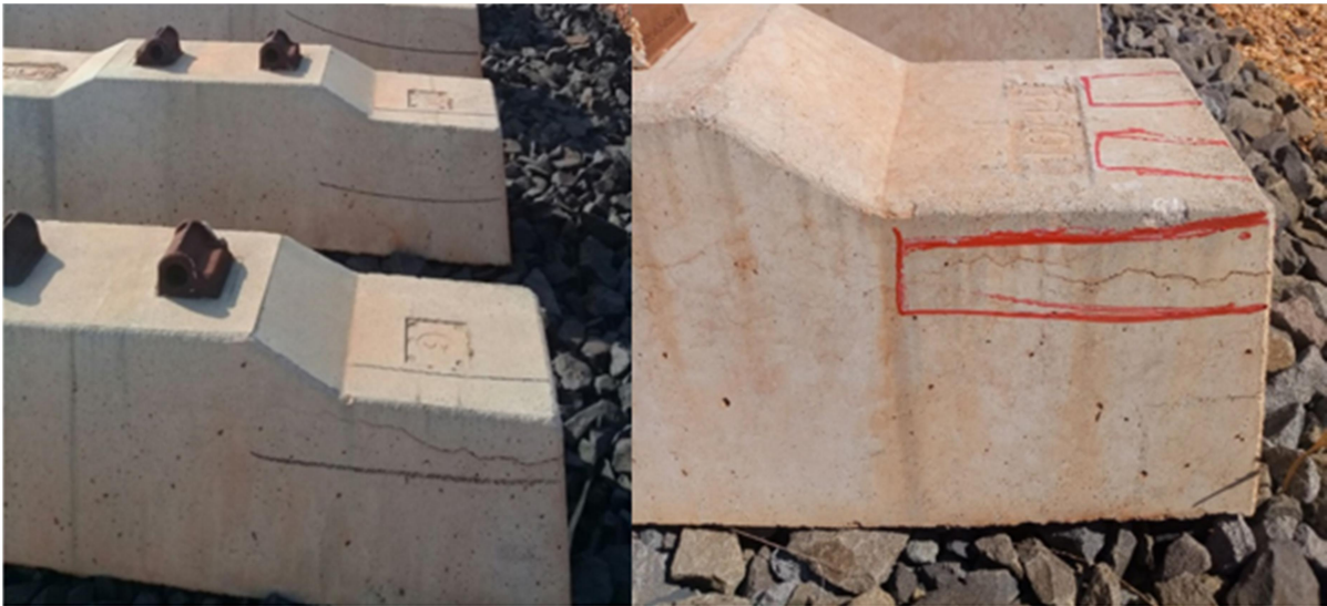
Figura 3 — Fissuras visíveis longitudinais em um dormente de concreto, destacando a necessidade de manutenção e reparo
