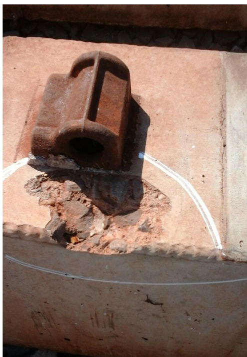
Figura 8 — Deterioração da região do apoio dos trilhos (RSD) (Fonte: INFRA S.A.)
