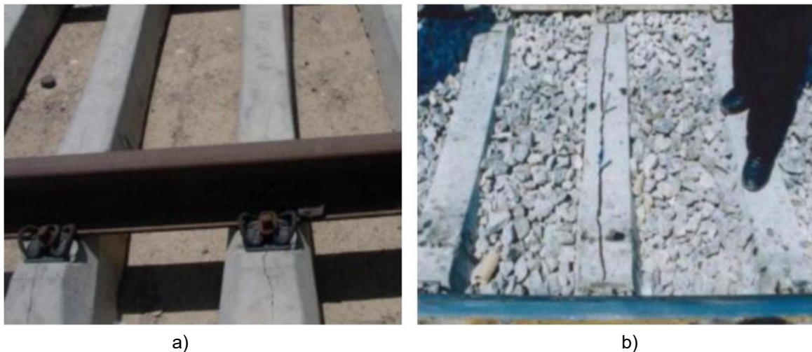
Figura 12 — Fissura longitudinal devido a tensão de tração entre dispositivos de fixação (Fonte: Rezaie et al, 2012)
