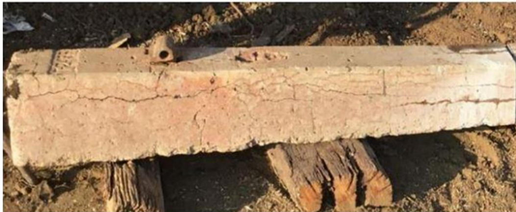
Figura 7 — Dormente com fissuração longitudinal decorrente de DEF (Fonte: Sundaram et al, 2018)
