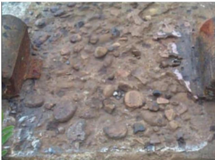
Figura 9 — Desgaste de dormente de concreto devido à abrasão do assento do trilho (Fonte: Zeman et al, 2009)
