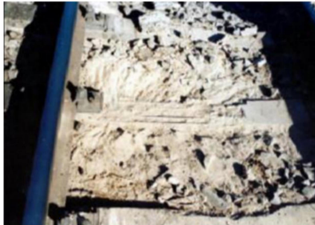
Figura 15 — Ruptura do dormente de concreto como resultado da corrosão da armadura
