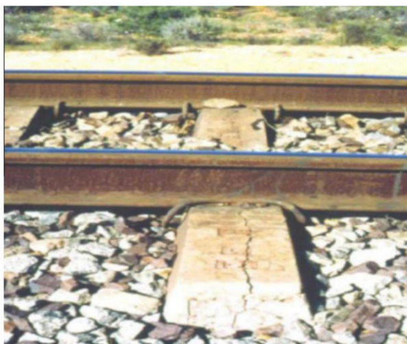
Figura 6 — Fissura em dormente de concreto devido a RAA (Fonte: Fournier et al. 2004)
