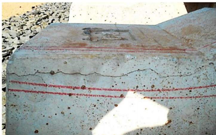
Figura 4 — Trinca Longitudinal (Fonte: INFRA S.A)
