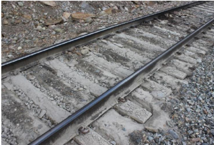
Figura 16 — Desgaste superficial do dormente de concreto e lastro contaminado (Fonte - Riding et al, 2018)
