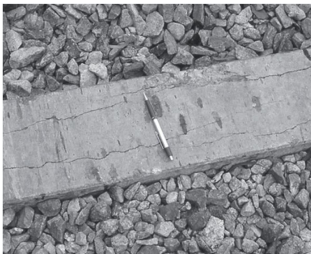
Figura 5 — Fissuras superficiais em dormente de concreto protendido (Fonte – Shayan, 2007)
