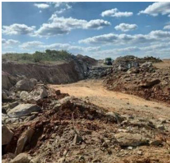
Fotografia 3 – Execução de escavação e transporte de material de terceira no trecho km 209.
