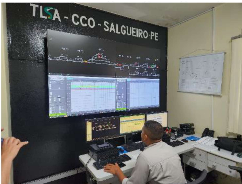
Fotografia 41 – Interior da sala do centro de controle e comando (CCO) da ferrovia TLSA.
